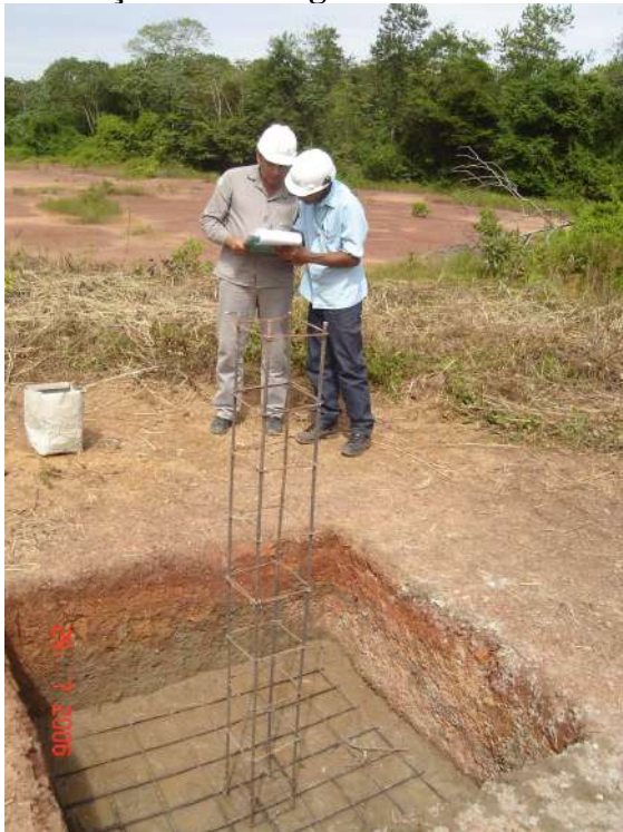
Colocação das ferragens das estacas e do pilar devidamente engastadas na ferragem da base
